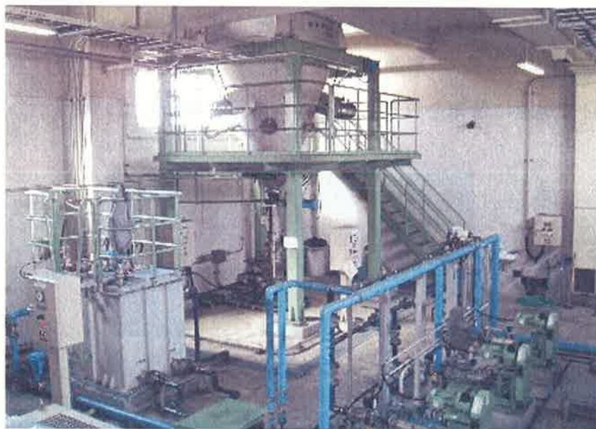
粉末活性炭注入設備
