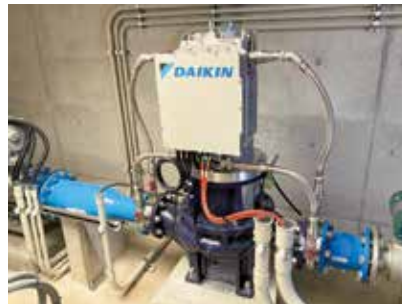
マイクロ水力発電設備
